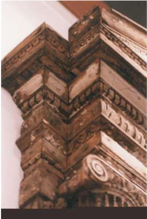
Pogled sa lijeve strane na najoštećeniji dio na oltaru. / kolovoz 2002. g.
