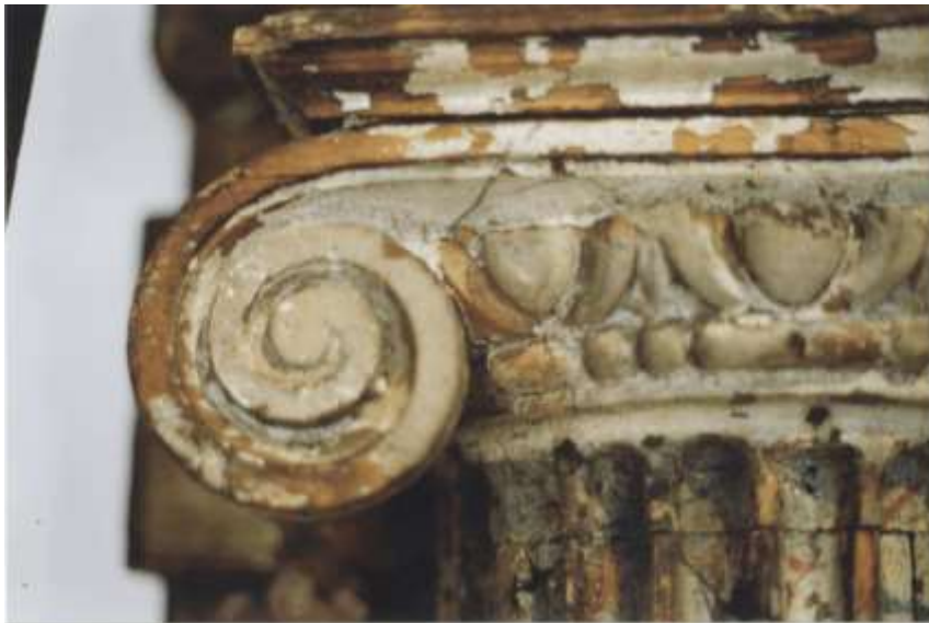
Detalj polukapitela na kojem su vidljiva oštećenja polikromije. / kolovoz 2002. g.
