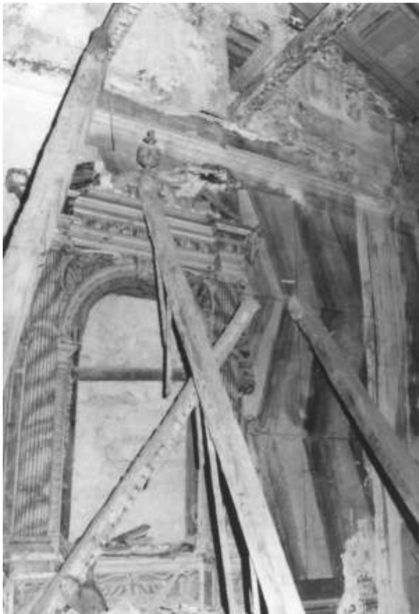
Zatečeno stanje objekta – ostaci oltara na istočnom zidu i urušene grede krovišta koji je popravljen 1987.g. / listopad 1991.g.
