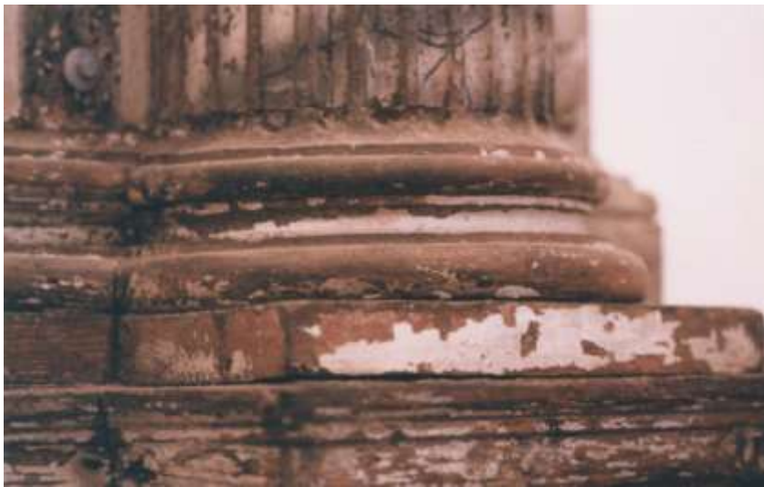
Polikromija profila lijevog polustupa jako je oštećena. / kolovoz 2002. g.
